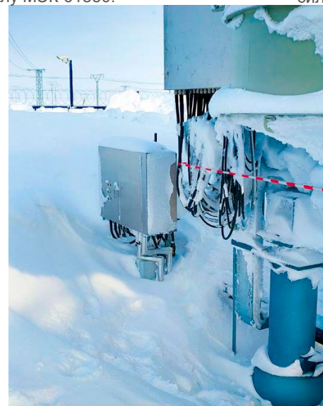
Опыт установки газоанализатора в экстремальных условиях (до -35^{\circ}\text{C} при установке, до -50^{\circ}\text{C} при эксплуатации) с дистанционным мониторингом через 3G.
