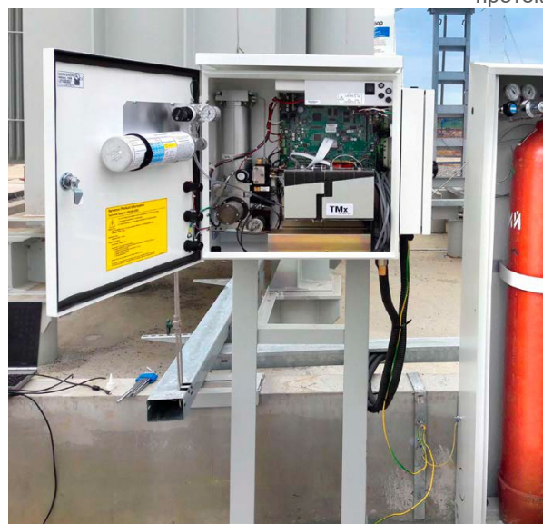
Многолетний опыт реализации проектов оснащения трансформаторов 110-750 кВ стационарными системами АРГ.
