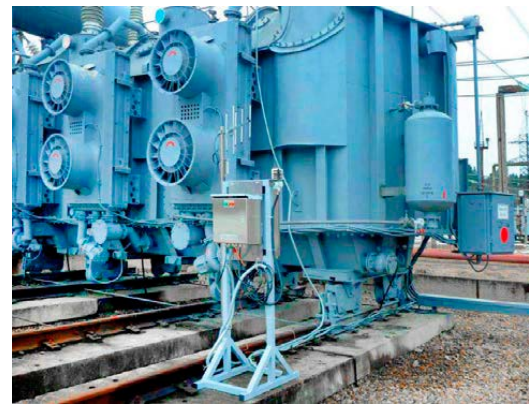
Мобильный (переносной) комплекс контроля и технической диагностики силовых трансформаторов.
