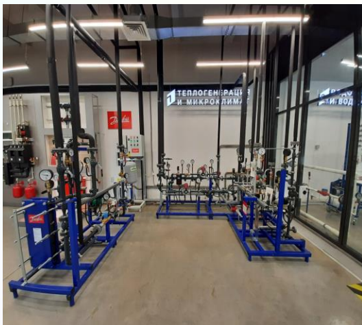
Блочный тепловой пункт
