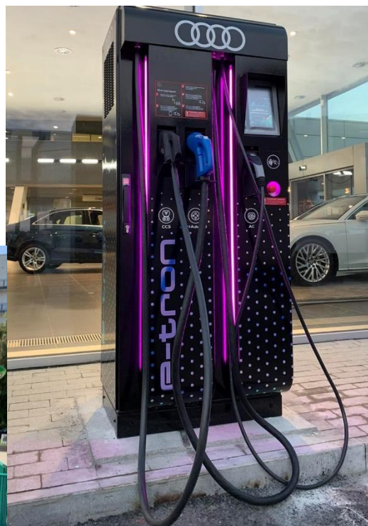
вид ЭЗС: DC, 50 кВт марка: KOSTAD объект: г. Тюмень, ДЦ Ауди Центр Тюмень
