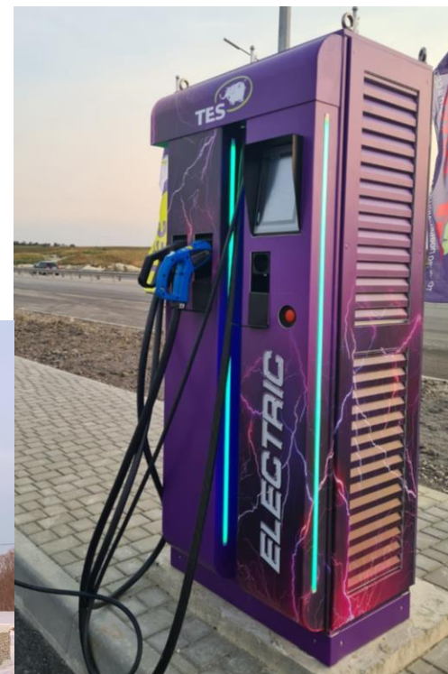
вид ЭЗС: DC, 120 кВт марка: KOSTAD объект: сеть АЗС TES, г. Симферополь
