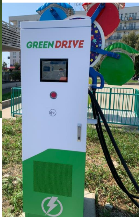
вид ЭЗС: DC, 60 кВт марка: Парус электро объект: паркинг отеля Имеритинский, г. Сочи
