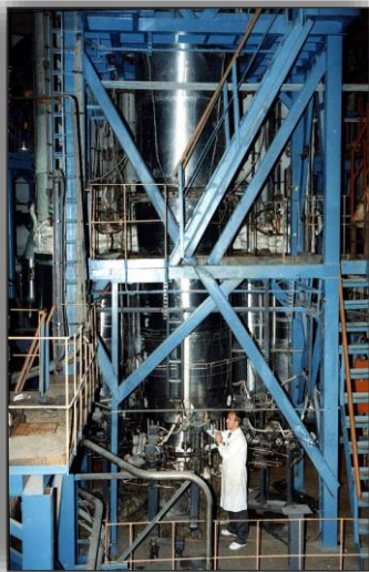
СТ-1312 (мощность 15 МВт)
