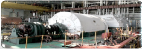
Турбогенератор ТВФ-63-2 ст.№№5,6,7 (производства Сибэлектротяжмаш) – 3 шт.
