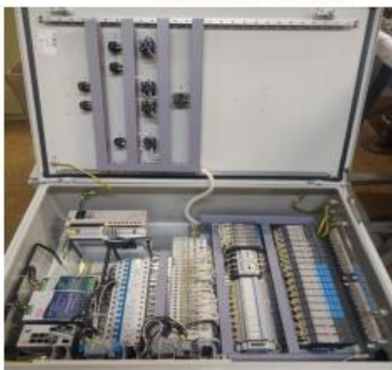
Блок системы автоматического управления
