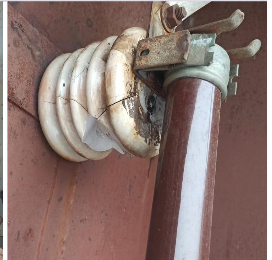
Разрушение опорного изолятора
