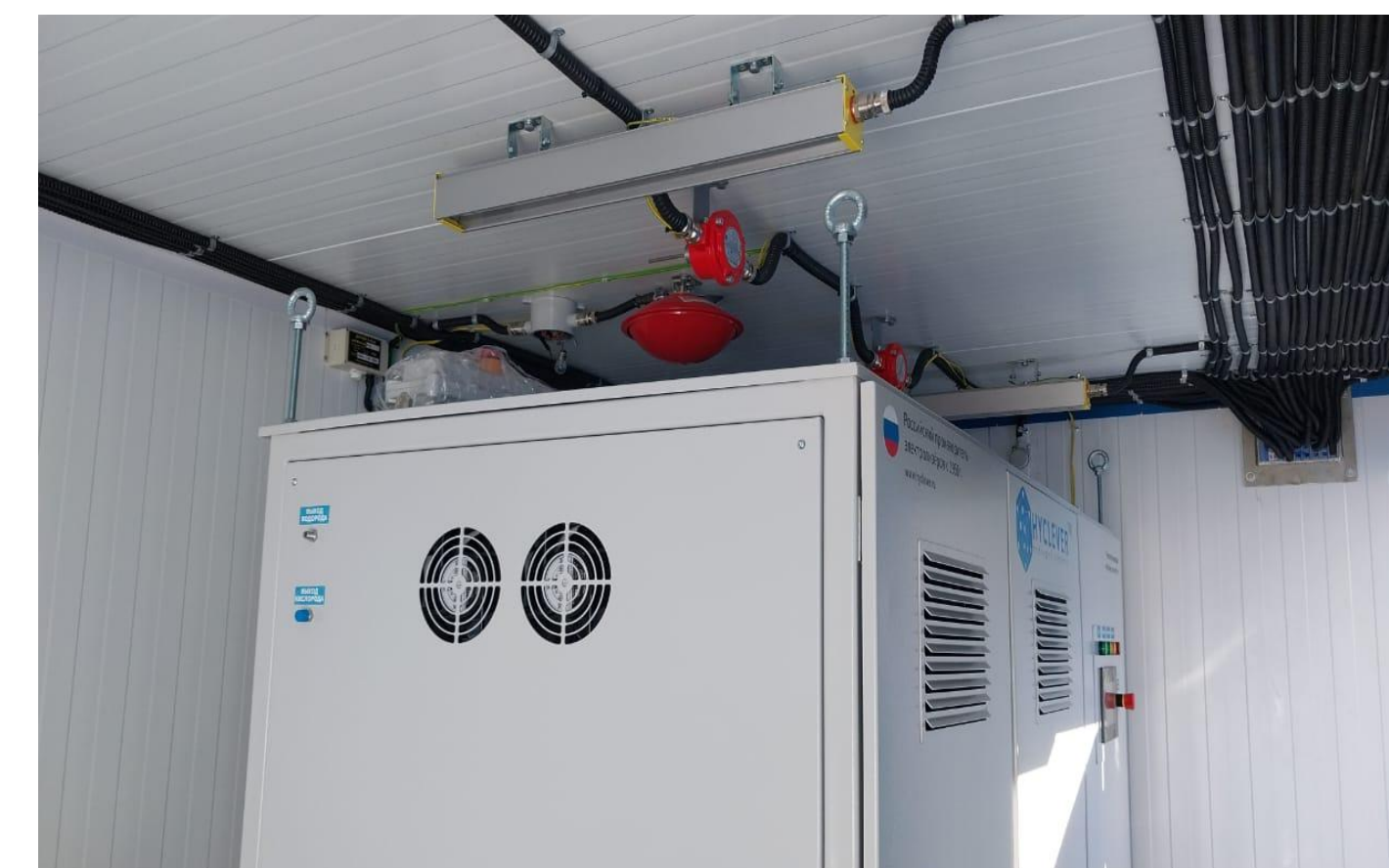
Система газоанализаторов и пожаротушения
