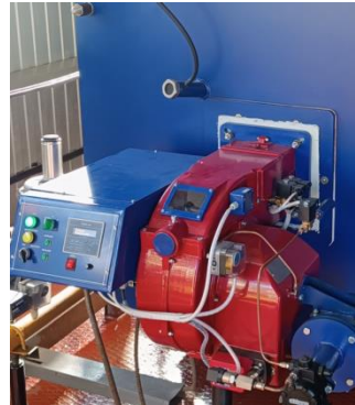
ЖКХ «Газтепло- жилсервис», пос.Зуевка, Кировская область
