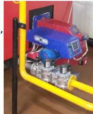
Котельная, г.Тобольск, Тюменская область
