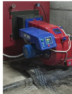
Котельная, г.Ульяновск, Ульяновская область
