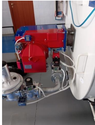
Котельная, ООО «Газпром Трансгаз Казань», г.Казань, республика Татарстан
