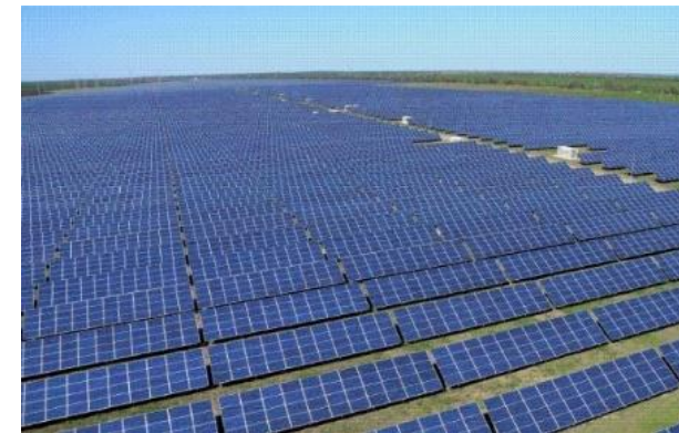
СЭС «Беларуснефть» 56 МВт
