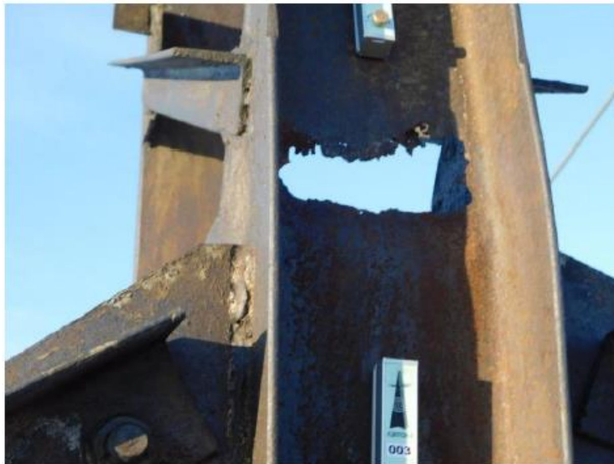
Рис. 18. Сквозное коррозионное разрушение пояса левой тросостойки опоры № 237. Потеря сечения составляет 45%
